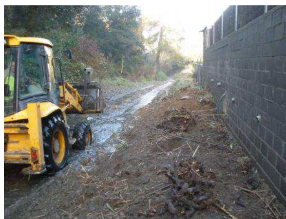
Máquina retroexcavadora realizando trabajos de arrancado de la caña en la riera de Vallvidrera en el tm de Sant Cugat del Vallès (Vallès Occidental)
